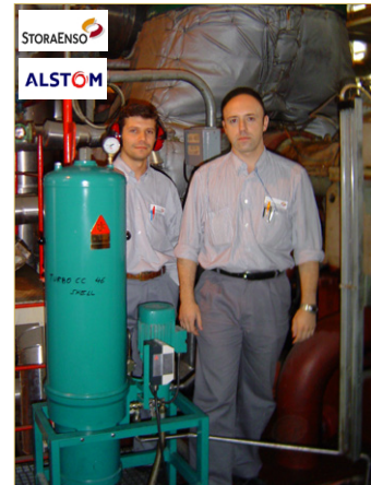
Installation des CJC® Ölpflegesystems an der Dampfturbine
