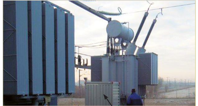
Transformator zur Energieversorgung der Eisenbahnschnellfahrstrecke
