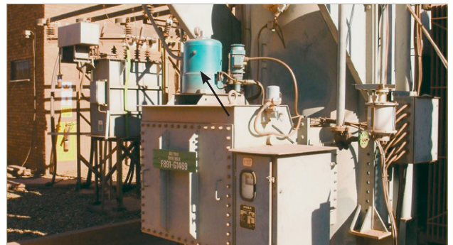
CJC® Ölpflegesystem 27/27 installiert am Tank der Leistungsschalter
