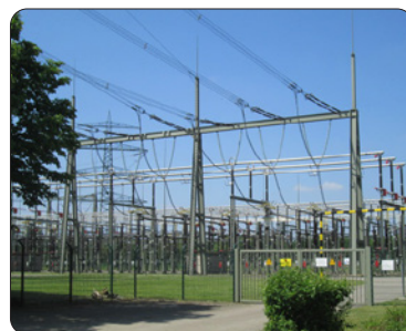
Freiluftschaltanlage des Umspannwerks Dortmund
