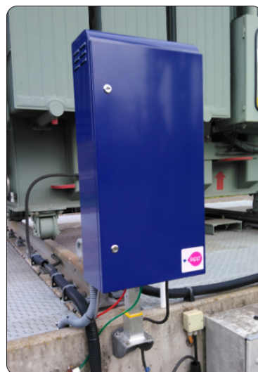
SIPP™ Node 500 installiert an der Trafowanne des Transformators Ua1
