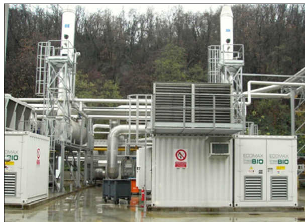
Jenbacher-Biogasmotor bei Montello spa
