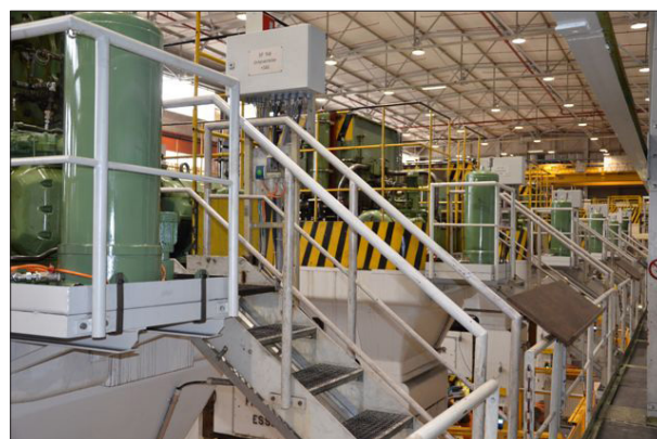
Pressenstraße GP-114 mit insgesamt 6 installierten CJC® Feinfilteranlagen des Typs 38/100
