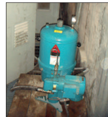
CJC® Filter Separator installiert an dem Hydrauliksystem der Vertikal-Rohmühle Nr. 4
