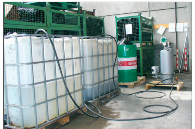
CJC® Ölpflegesystem 27/54 in Betrieb: die Tanks mit dem verschmutzten und dem sauberen Öl sind deutlich zu erkennen
