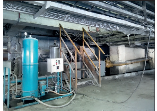
Republic Cement Iligan, Inc. - Getriebe der Feinmühle Nr. 1 mit installierter CJC® Feinfilteranlage 27/108.
