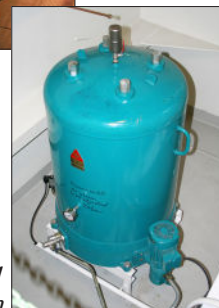
CJC® Ölpflegesystem 427/81 installiert im Maschinenraum
