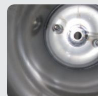
Lackartige Ablagerungen auf der Metalloberfläche wurden entfernt
